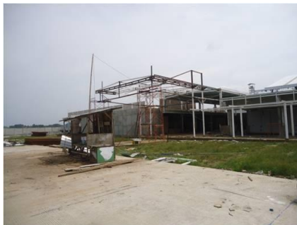
Gambar 1. Kondisi struktur cantilever dengan pipa
