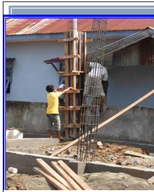
Gambar 11 : Pembesian kolom selesai dan mal kolom sedang dikerjakan pada proyek pembangunan Gedung Serbaguna GBKP Marendal – Mekatani Kabupaten Deli Serdang.
