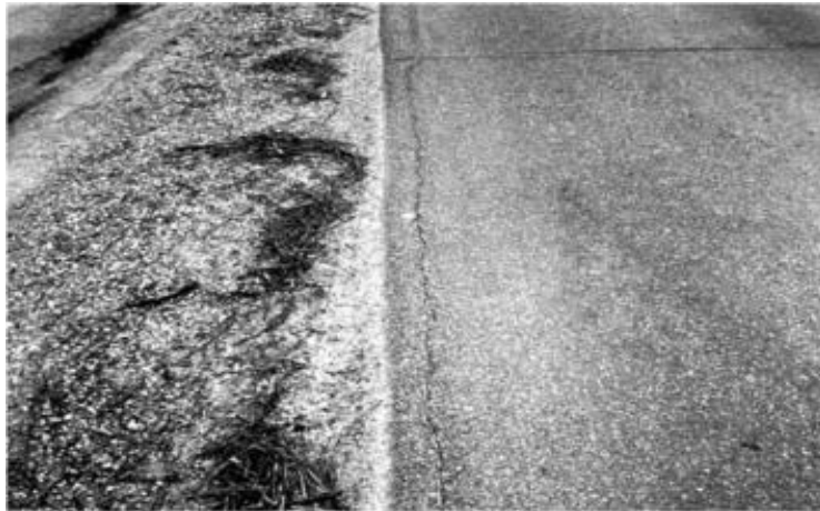
Gambar 2.7. Jenis kerusakan retak pinggir ( Edge Cracking )
