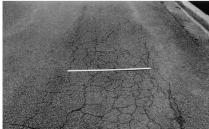
Gambar 2.2. Jenis kerusakan retak kulit buaya ( Alligator Cracking )
