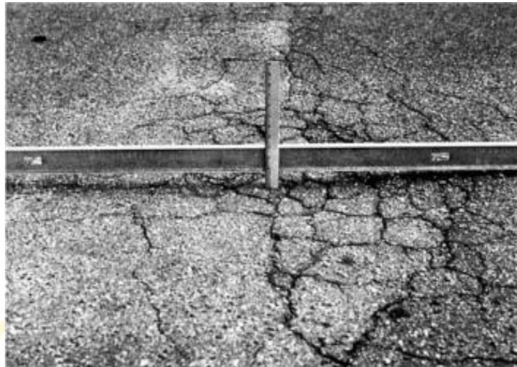
Gambar 2.6. Jenis kerusakan amblas ( Depression )
