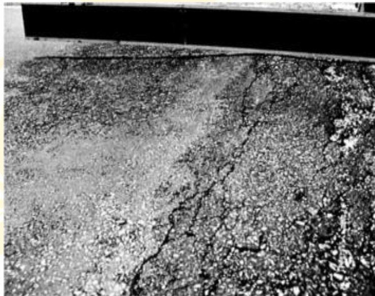
Gambar 2.5. Jenis kerusakan tonjolan dan lengkungan ( Bumps and Sags )
