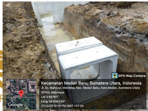
FOTO XXIV Erection Box Sumber: Foto Pribadi
