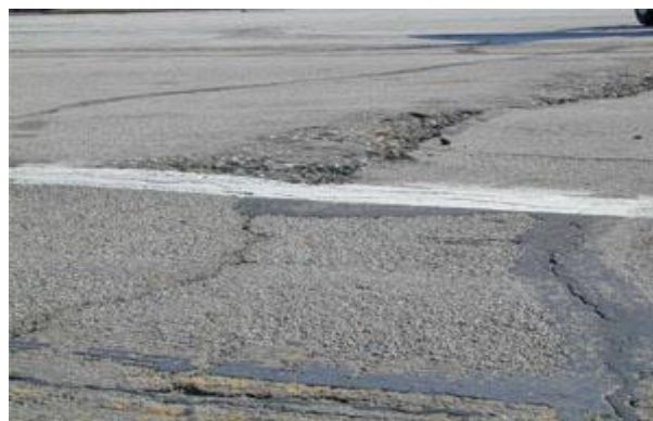
Gambar 2.14 Kerusakan Jembul ( Swell )
