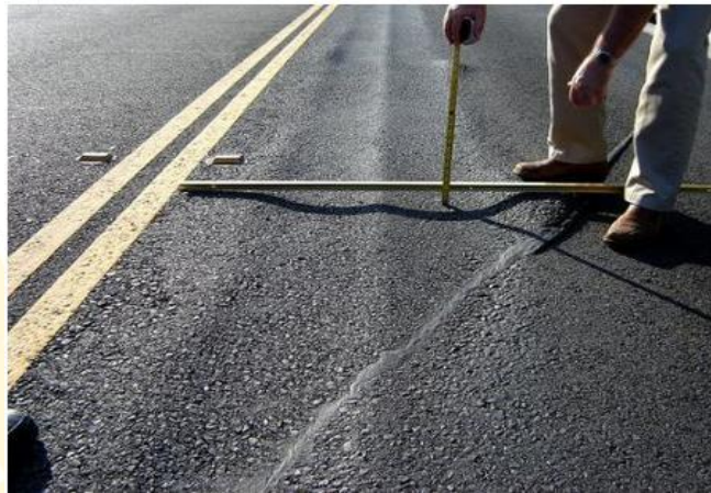
Gambar 2.10 Kerusakan Alur ( Rutting )
