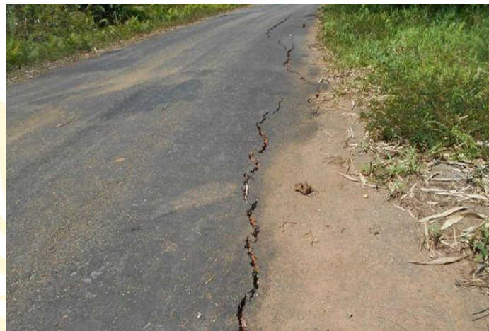
Gambar 2.6 Kerusakan retak Pinggir ( Edge Cracking )
