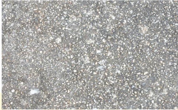
Gambar 2.17 Kerusakan Pengelupasan ( Stripping ) Sumber: www.istockphoto.com
