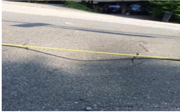
Gambar 2.13 Kerusakan Amblas ( Depression )
