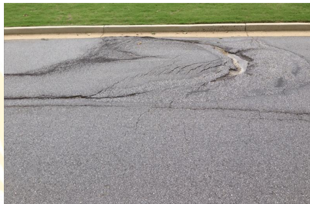
Gambar 2.9 Retak Selip ( Slippage Cracks )
