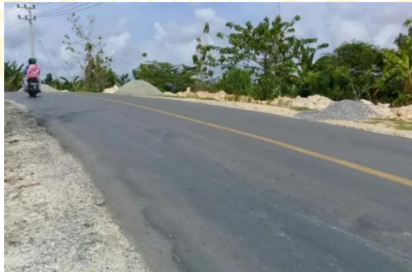
Gambar 2.20 Kerusakan Kegemukan ( Bleeding ) Sumber: https://hotmixindo.com/pengertian-bleeding-pada-aspal/
