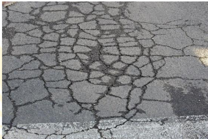
Gambar 2.5 Kerusakan retak kulit buaya ( Alligator Cracking )
