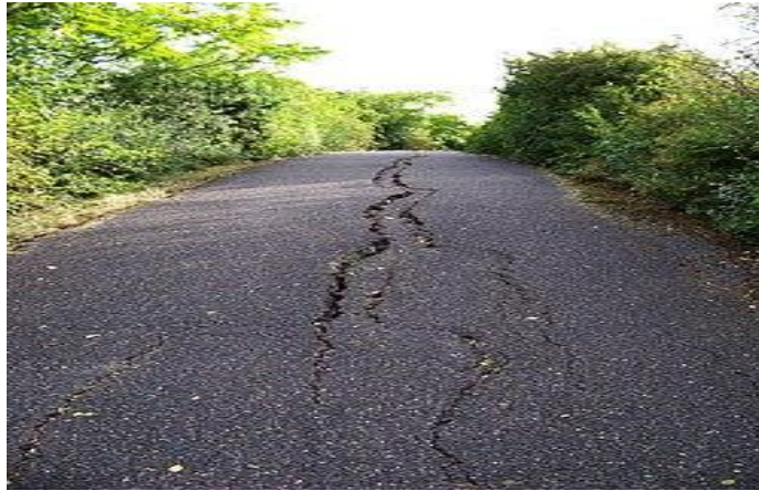
Gambar 2.7 Kerusakan Retak Memanjang & Melintang ( Longitudinal & Transverse Cracking )
